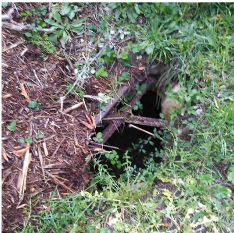
fig. 16 : Voûte effondrée de la 2ème terrasse (© Géocarta)
