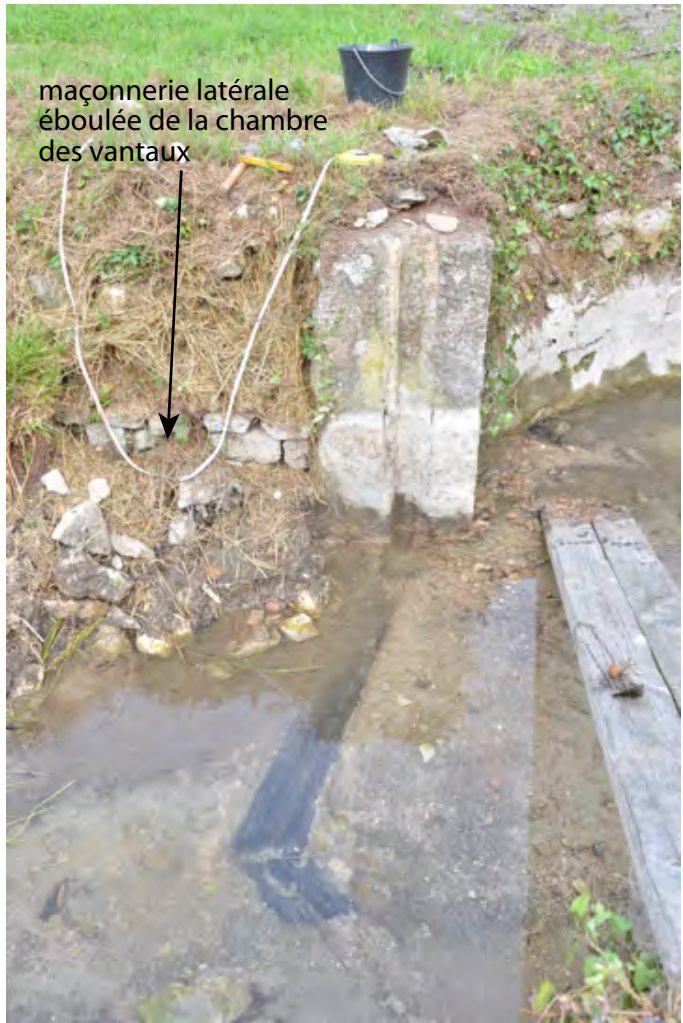
fig. 4 : Dormants en bois de l'écluse amont - © C. Travers
