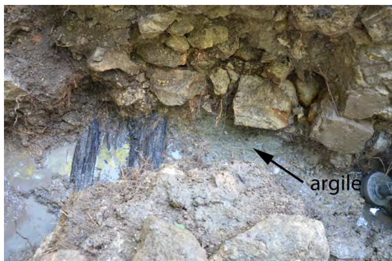
fig. 35 : Corroi argileux observé sous le mur de berge rive gauche (sondage S.X) - © C. Travers
