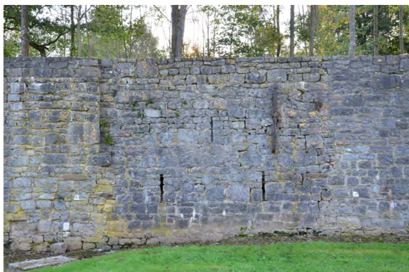
fig. 84 : La face antérieure du mur de soutènement du potager, présence d'une ancre en fer forgé © C. Travers
